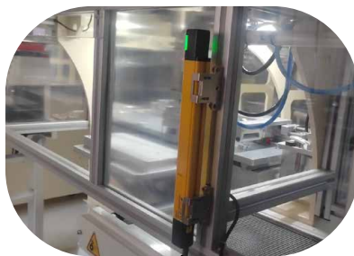
Cabina de seguridad
